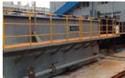
Tanque de flotación de aire
