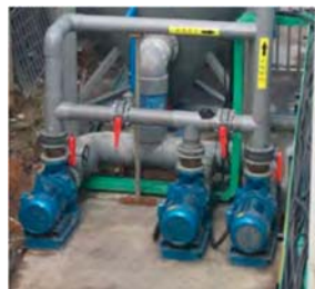
Bombas de TMF
