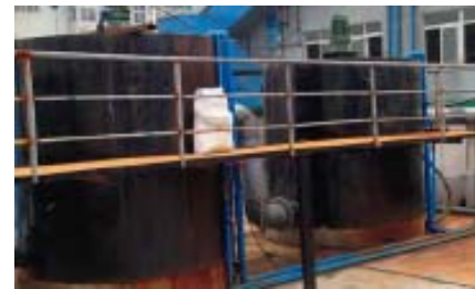
Tanque de ajuste de pH n° 2/ Tanque de reacción
