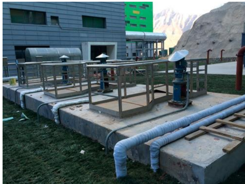
Tanques de reacción y tanque de concentración (subterráneos)
